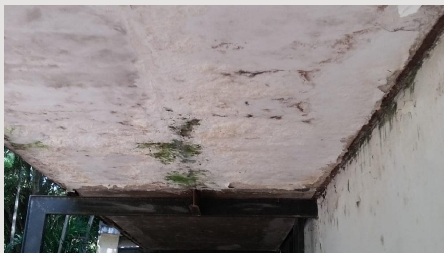
Parte de infraestructura deteriorada y con proliferación de hongos 16
