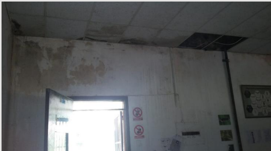
Aula con filtraciones de agua y proliferación de hongos 15
