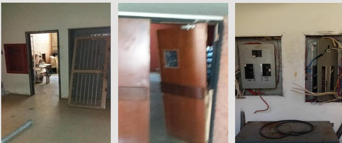
Imagen donde se evidencia el daño causado en los robos. Fuente: Anónima.
